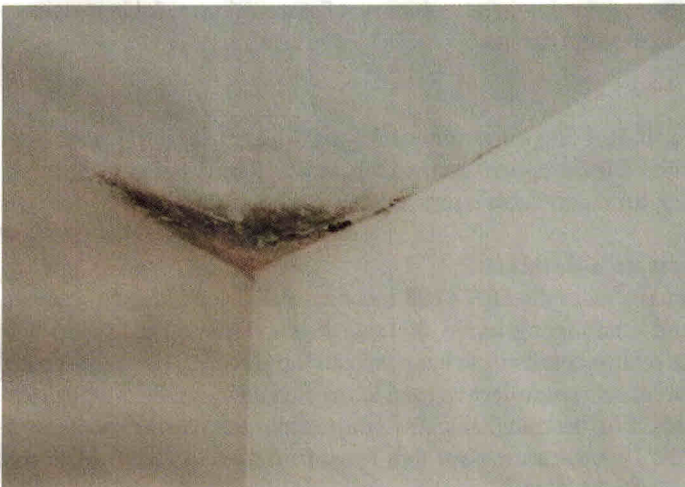
Schimmelpilzbildung im Eckbereich
